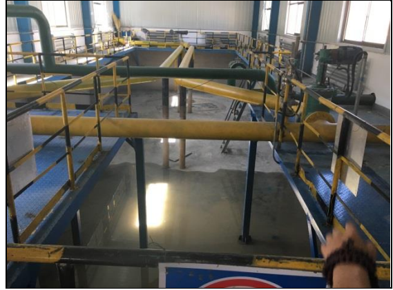
图 2-4 二级泵站内事故池
