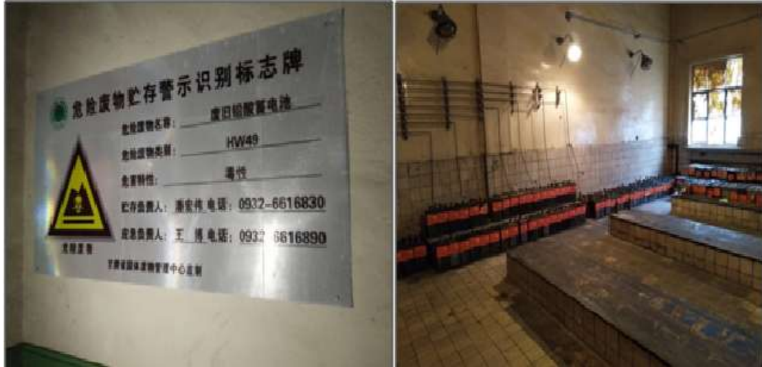
废铅蓄电池暂存设施
