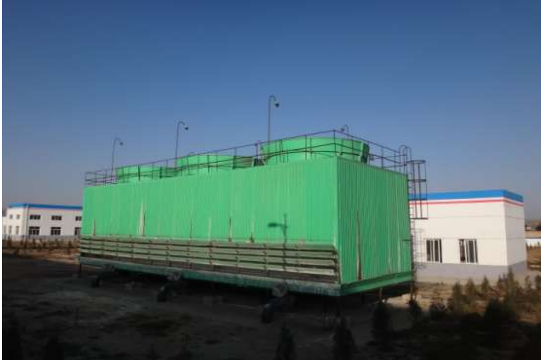
循环水冷却塔
