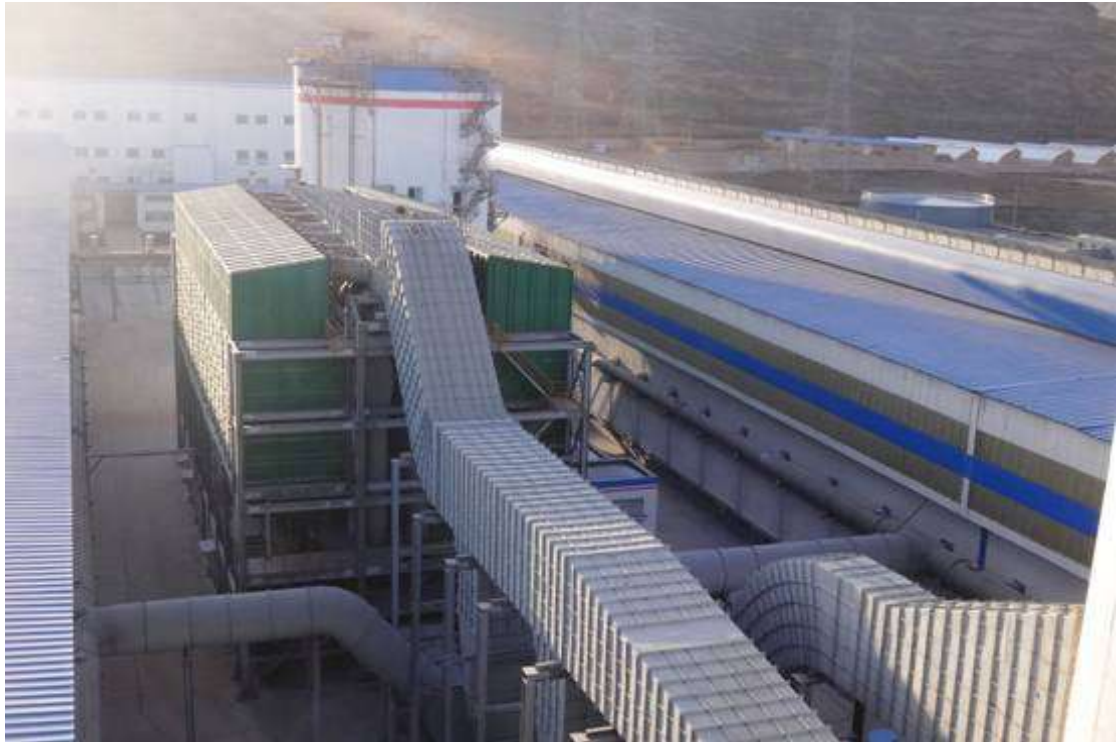
电解烟气净化系统布袋除尘器
