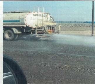
4月14日三标K54基施工道路红线外被扰动区域洒水形成结皮防止风蚀整改到位
