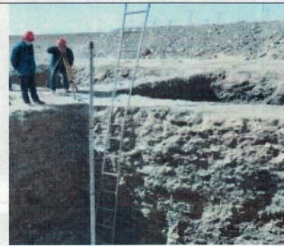
3月二标K23塔基 临时堆渣未采取苫盖措施
